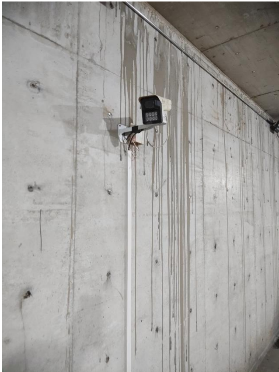
图 3-13 小管探伤室监控装置 2
