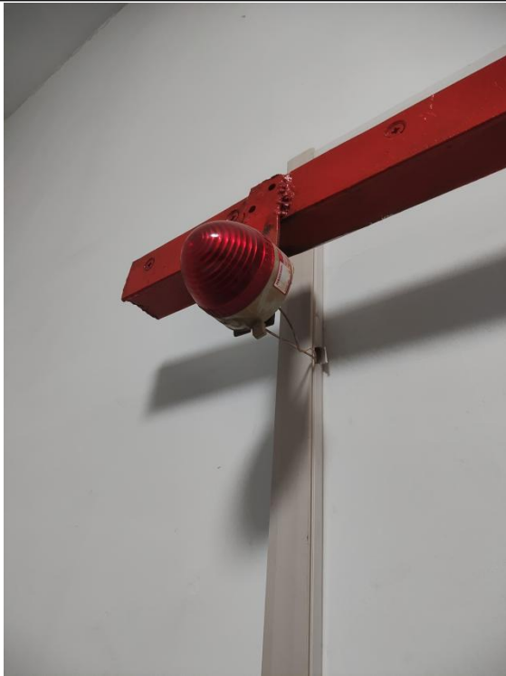
图 3-23 大管探伤室小防护门信号警示装置
