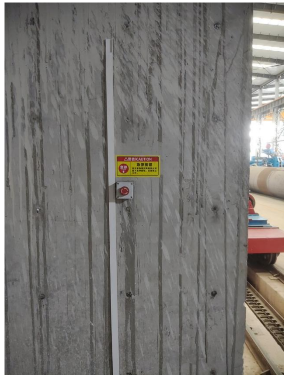
图 3-10 小管探伤室若干紧急停机按钮 2
