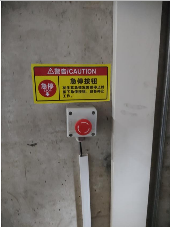
图 3-27 大管探伤室若干紧急停机按钮 3
