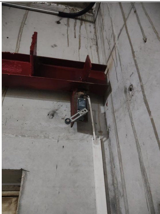
图 3-4 小管探伤室小防护门门机联锁
