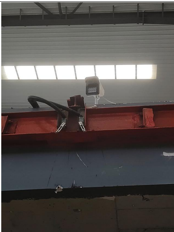
图 3-3 小管探伤室大防护门门机联锁
