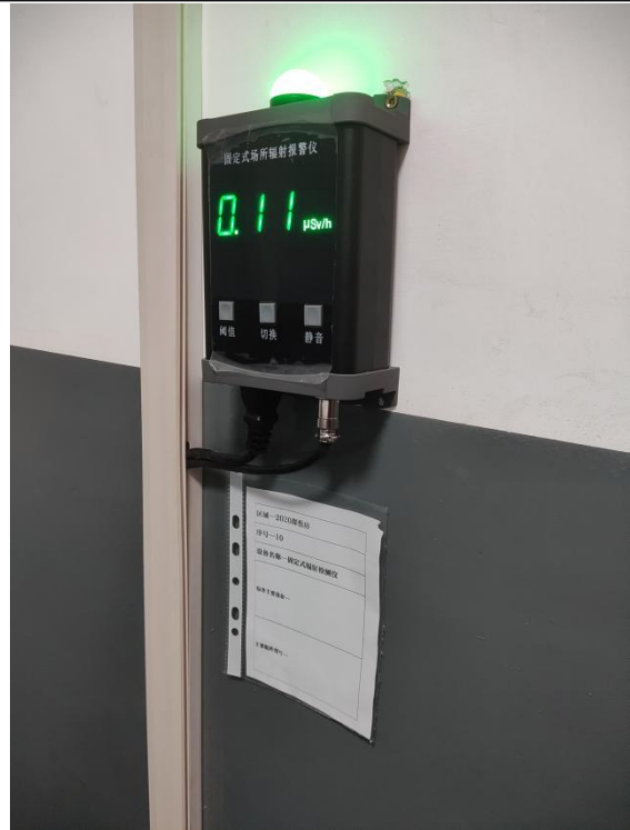
图 3-32 大管探伤室固定式剂量探测器
