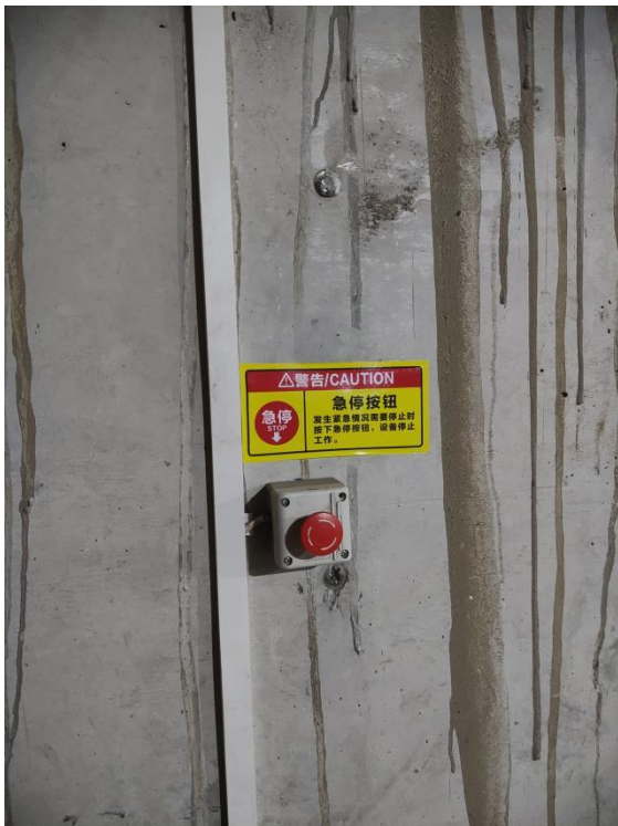
图 3-9 小管探伤室若干紧急停机按钮 1
