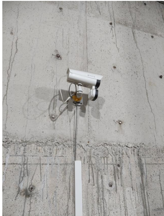
图 3-46 3620 管线探伤室监控装置 3
