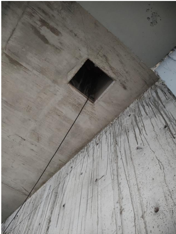
图 3-33 大管探伤室排风口
