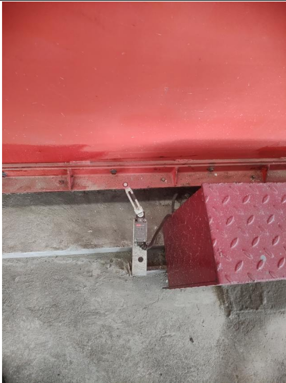
图 3-35 3620 管线探伤室大防护门门机联锁
