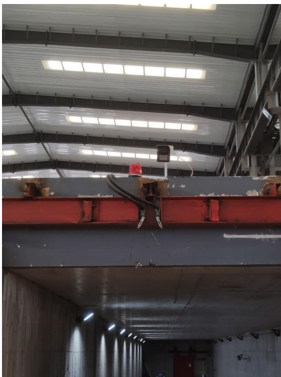
图 3-5 小管探伤室大防护门信号警示装置
