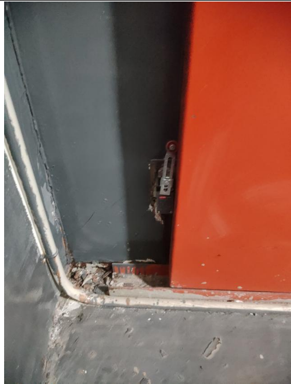
图 3-36 3620 管线探伤室小防护门门机联锁
