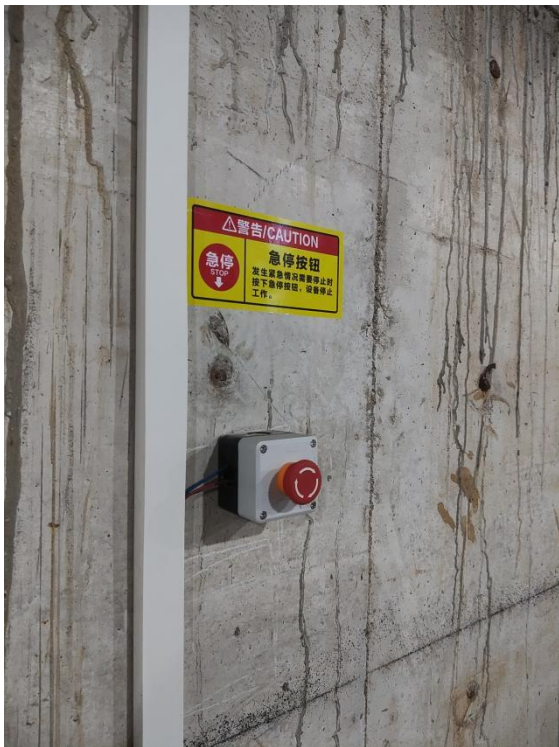
图 3-41 3620 管线探伤室若干紧急停机按钮 1
