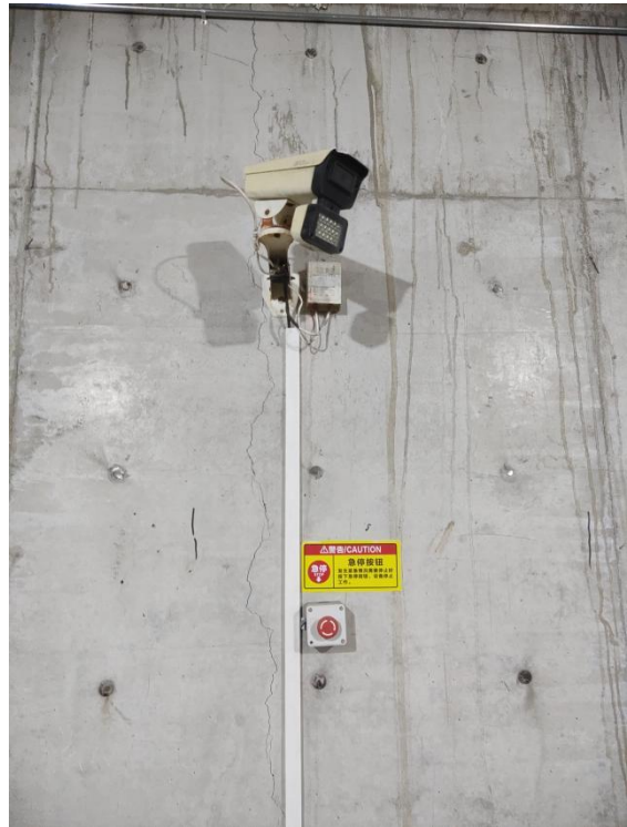
图 3-14 小管探伤室监控装置 3
