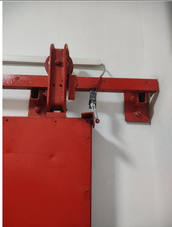
图 3-20 大管探伤室小防护门门机联锁
