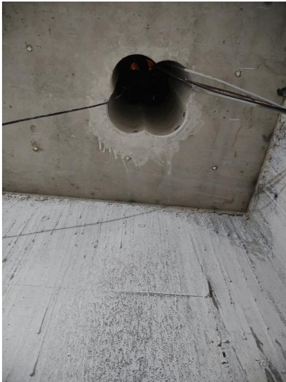
图 3-17 小管探伤室排风口
