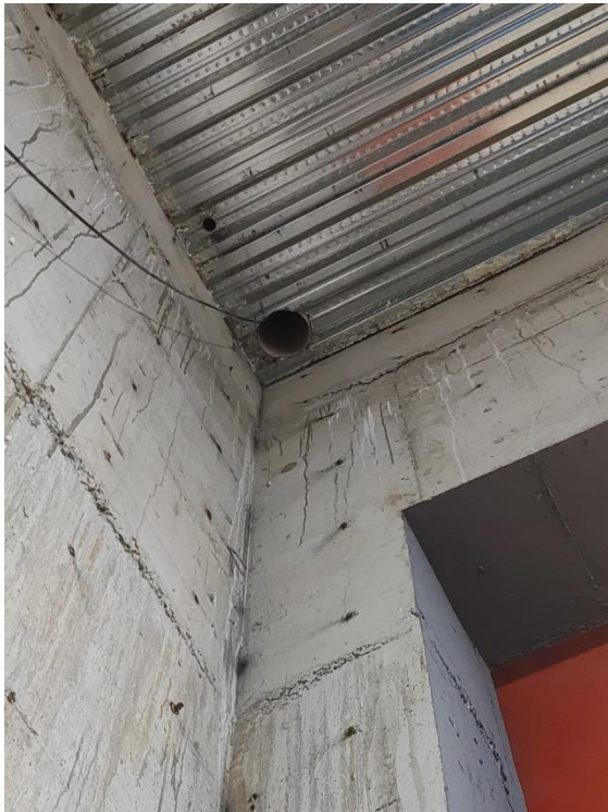
图 3-49 3620 管线探伤室排风口
