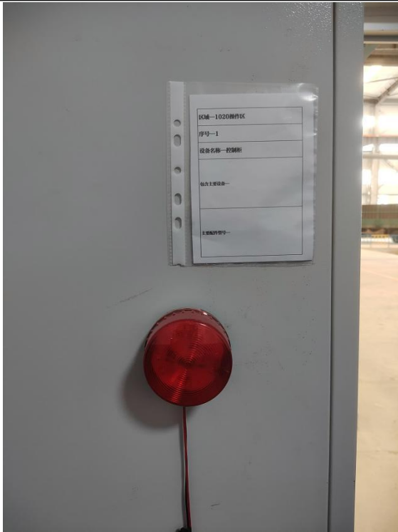
图 3-7 小管探伤室小防护门信号警示装置
