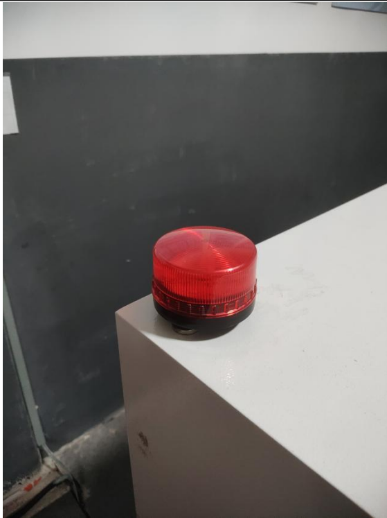
图 3-39 3620 管线探伤室小防护门信号警示装置
