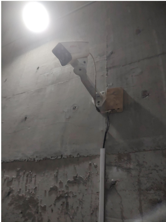
图 3-29 大管探伤室监控装置 2
