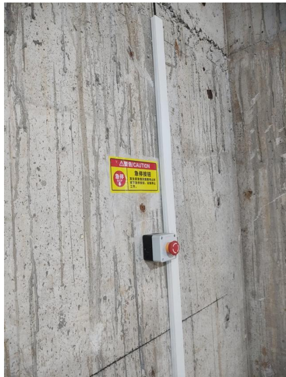
图 3-42 3620 管线探伤室若干紧急停机按钮 2
