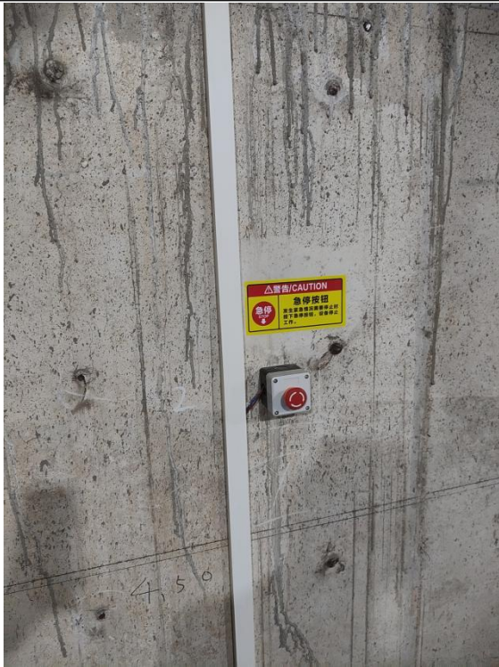
图 3-43 3620 管线探伤室若干紧急停机按钮 3
