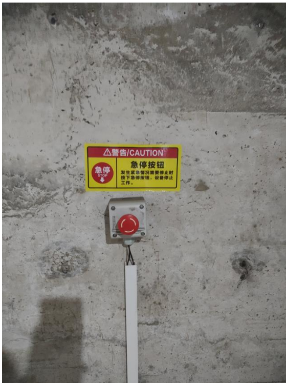
图 3-25 大管探伤室若干紧急停机按钮 1
