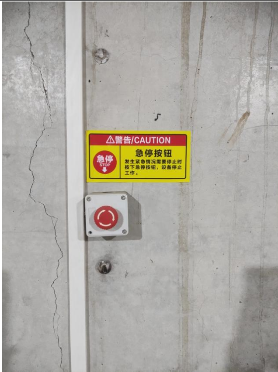
图 3-11 小管探伤室若干紧急停机按钮 3
