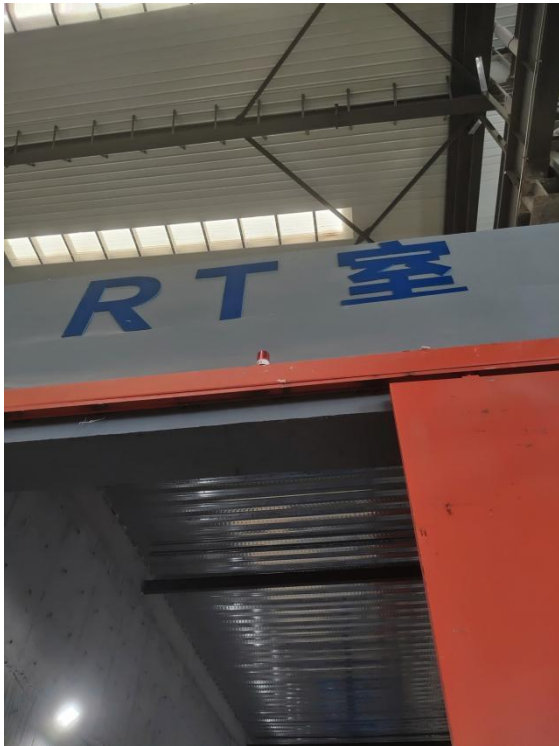
图 3-37 3620 管线探伤室大防护门信号警示装置
