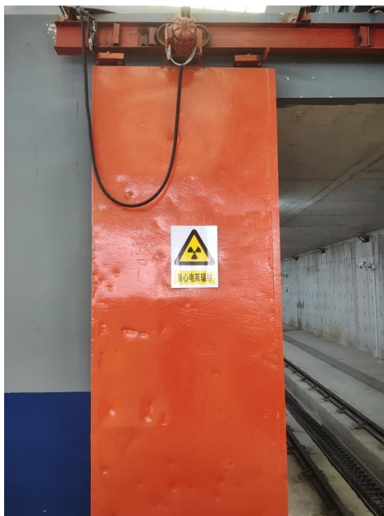
图 3-6 小管探伤室大防护门电离辐射警告标志
