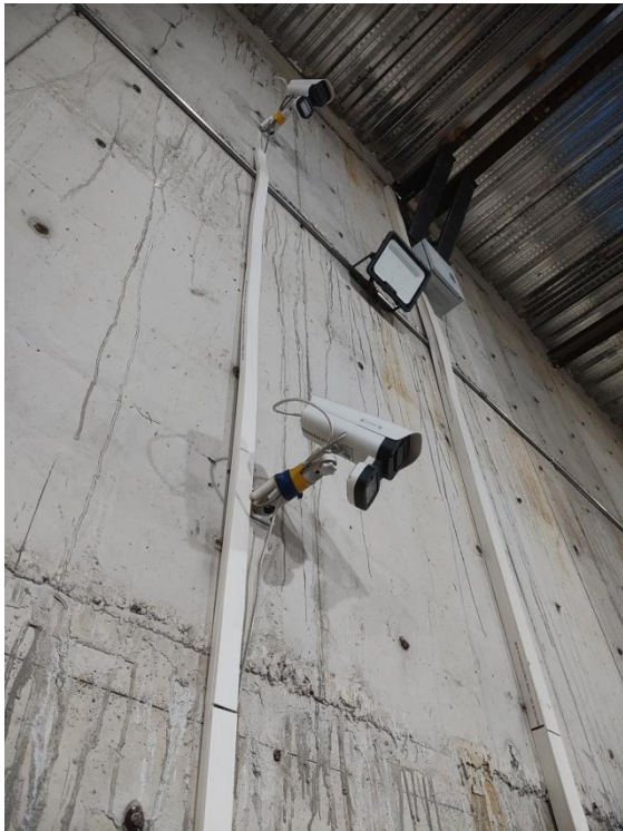
图 3-45 3620 管线探伤室监控装置 2
