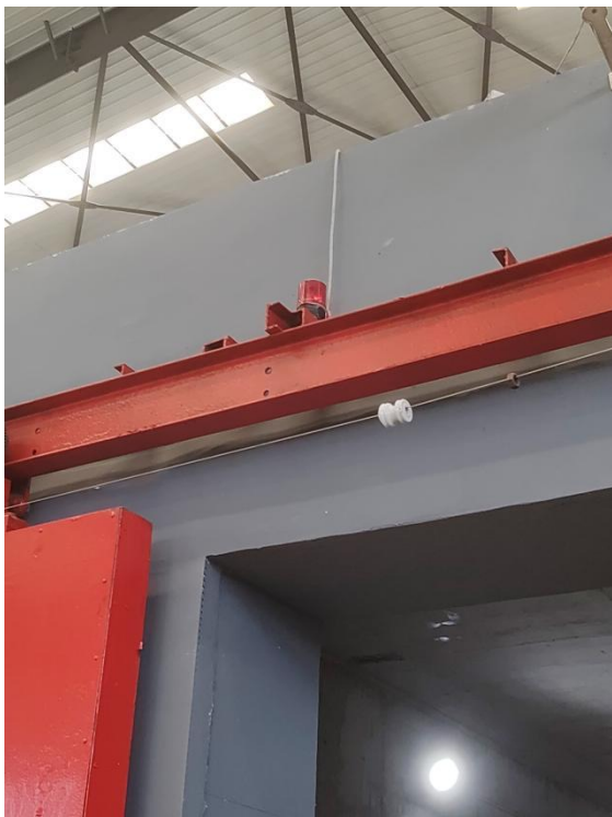
图 3-21 大管探伤室大防护门信号警示装置
