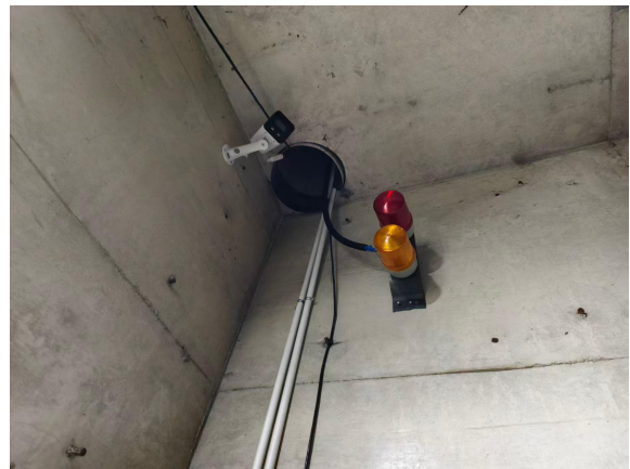
图 3-13 曝光室内监控装置
