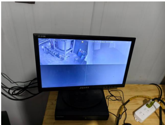
图 3-14 操作室内监控显示器
