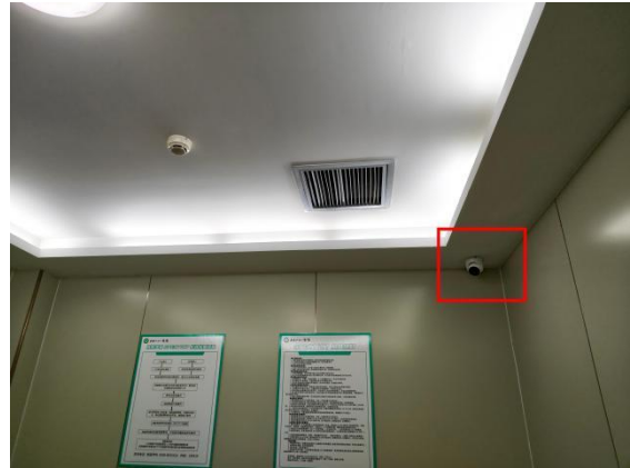
图 3-21 SPECT-CT 候诊室进风口、监控装置
