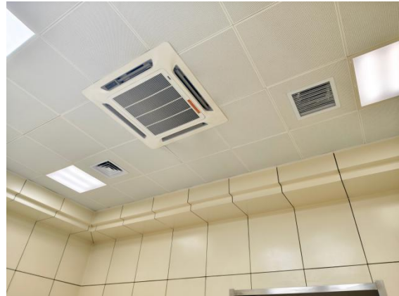
图 3-15 SPECT-CT 机房进风口
