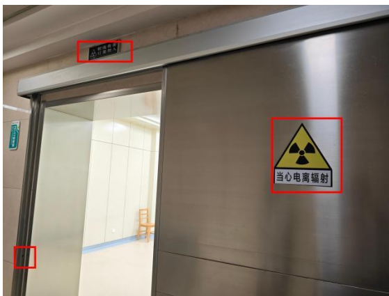
图 3-9 PET-CT 机房电离辐射警告标志、工作状态指示灯、红外防夹装置
