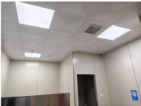
图 3-11 SPECT-CT 留观室进风口、监控探头
