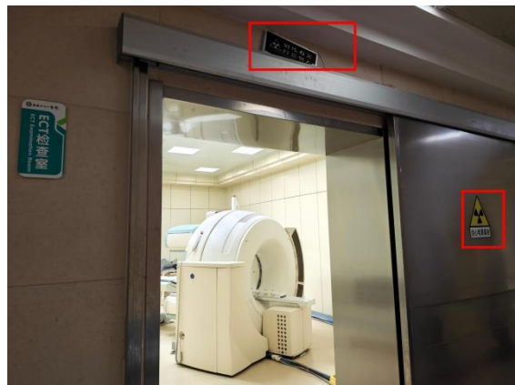
图 3-12 SPECT-CT 机房电离辐射警告标志、工作状态指示灯
