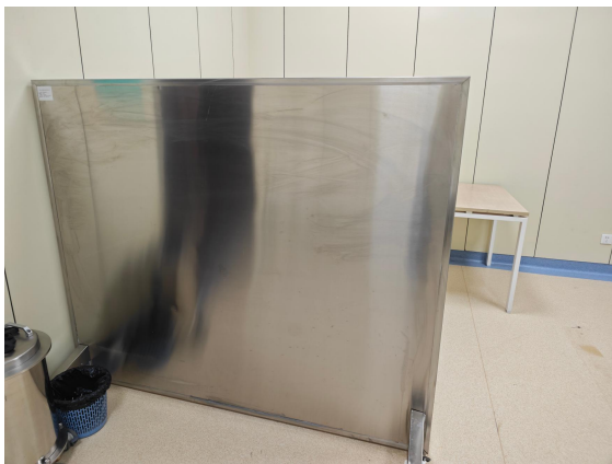
图 3-18 PET-CT 候诊室铅屏风
