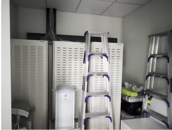
图 2-9 DSA 介入二室东侧设备机房
