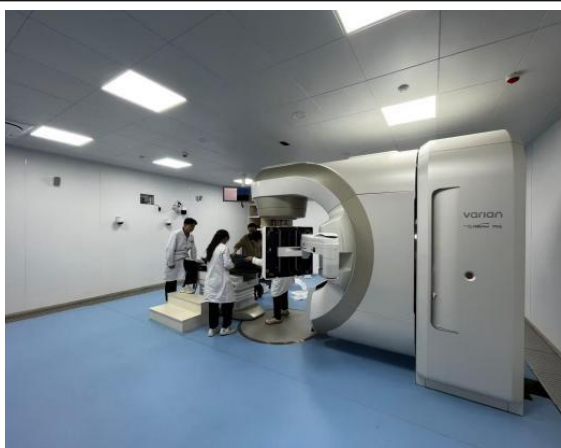
图 2-5 直线电子加速器一室内部
